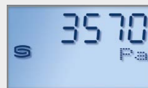
Давление [Pa] (inWC)
